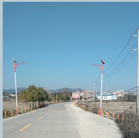
上交所资助街区路灯亮化提升项目
